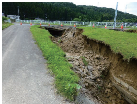
写真-14 水路への浸水被害
