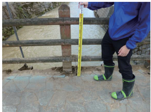
写真-4 湯ノ又川橋の被害
