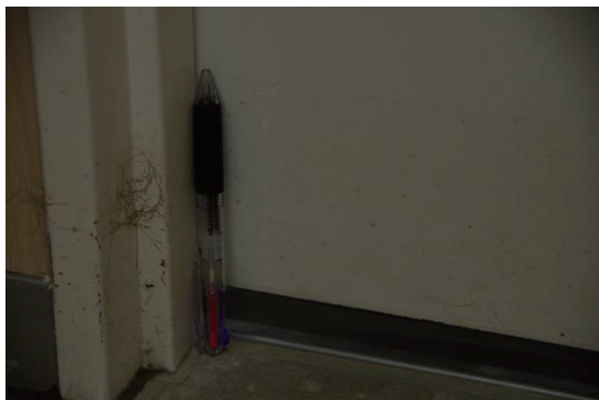
写真-13 トイレ内の浸水痕
