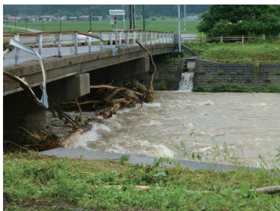
写真-7 橋脚に堰止められた流木
