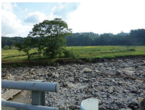
写真-13 河岸洗堀の様子
