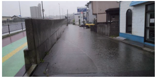
写真-2 道路の冠水による被害
