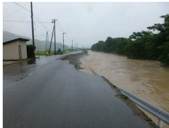
写真-6 左岸の洗堀の状況
