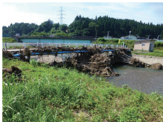
写真-14 河岸洗堀の様子
