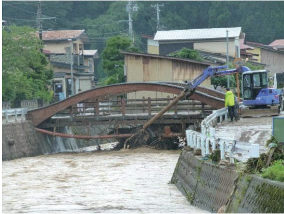
写真-9 橋に引っ掛かった流木
