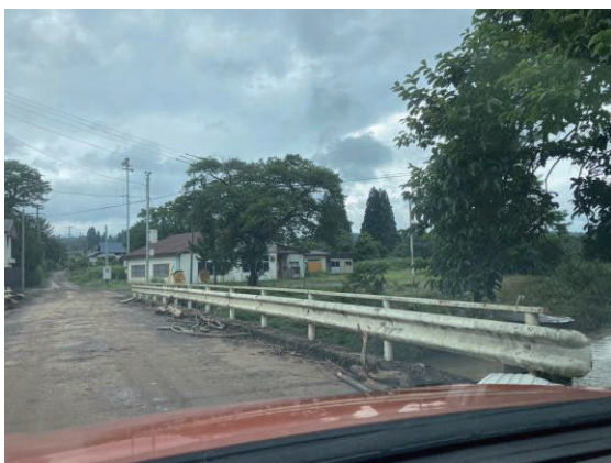
写真-11 上岩川周辺の被害
