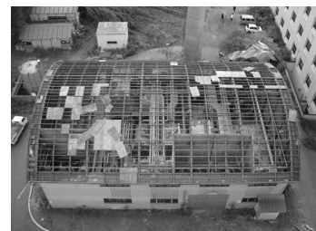
(c)ボイラー棟の屋根被害
