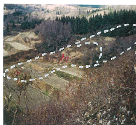
写真－8 A－7ブロック 末端部水田の盛り上がり状況 （地すべり防止区域指定時）
