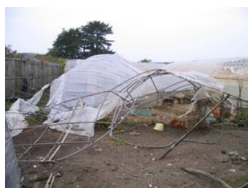
図5 倒壊したビニールハウス
