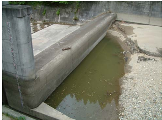
図-14 固定堰部上流側河床の洗掘事例（2） 葛丸頭首工（岩手県，平成19年9月27日三輪撮影）
