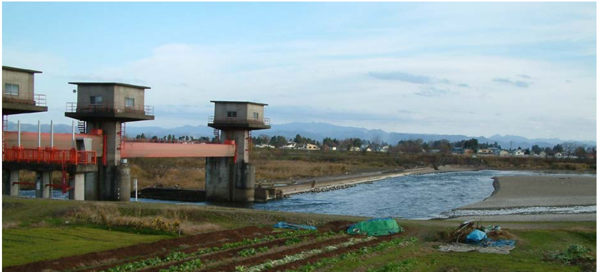
図-13 固定堰部上流側河床の洗掘事例（1） 山城頭首工（秋田県雄物川，平成22年11月25日三輪撮影）
