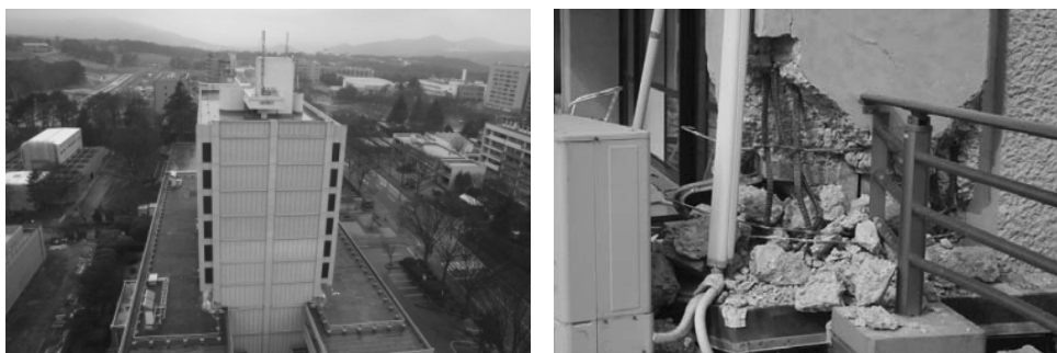
写真1 東北大学工学部の人間・環境系研究棟と3階柱脚部の被害
