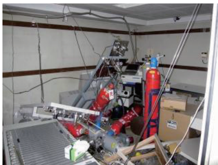
写真1 高圧ガスボンベの被害
