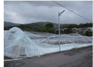
図1 強風被害例(長崎県提供)
