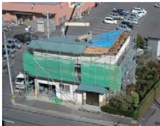
図1 小屋組の強風被害
