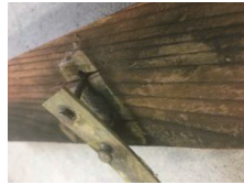
図 9 強制腐朽を行った試験体でみられた特徴的な破壊
