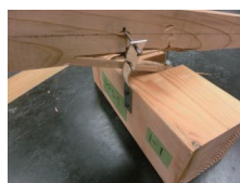
(a) 垂木の割れ
