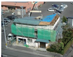
図1 小屋組の被害
