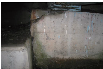
写真-2 判別に用いた劣化損傷状態1の画像
