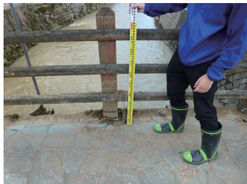
写真-4 湯ノ又川橋の被害
