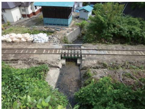
写真-11 浸水箇所（幅 2.2m）
