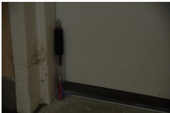
写真-13 トイレ内の浸水痕
