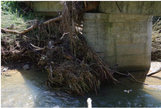
写真-9 橋脚に堰止められた流木
