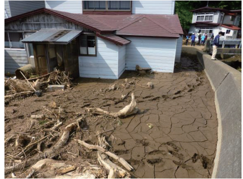
写真-16 流木・土砂の堆積
