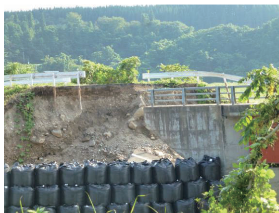
写真-14 落橋して寸断された道路
