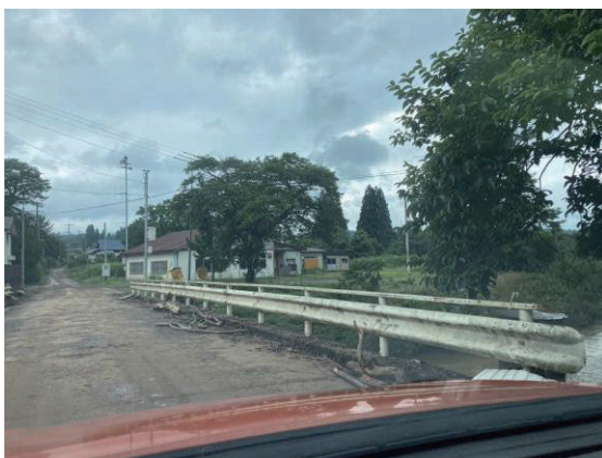
写真-11 上岩川周辺の被害
