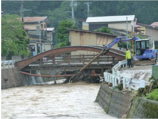
写真-9 橋に引っ掛かった流木
