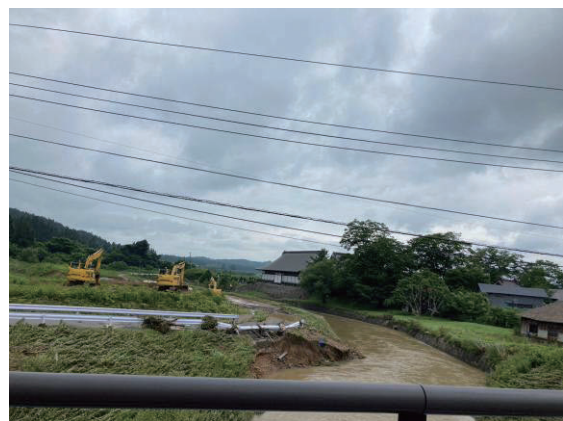
写真-12 護岸の洗堀と改修
