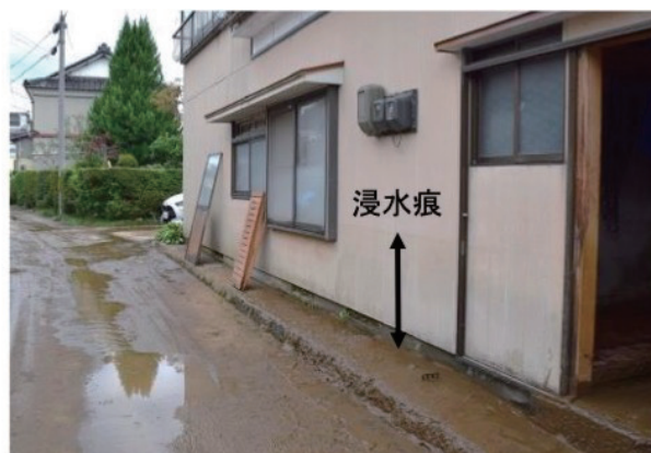
図5 荒瀬川の氾濫による市街地の浸水被害（酒田市麓）（7月27日撮影）。
