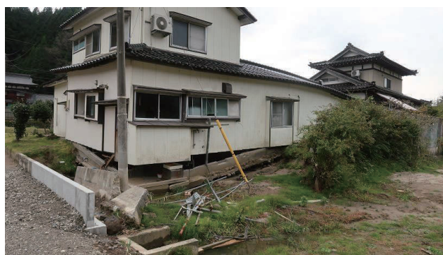
写真 4 盛土の流出と基礎梁の破壊
