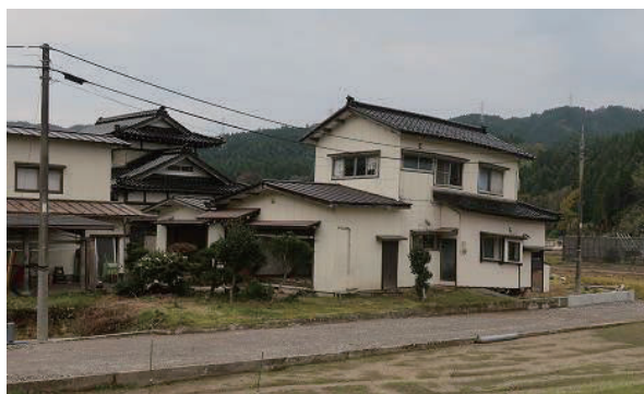
写真 3 不同沈下した住宅
