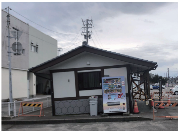
図5 傾斜した伏木駅前公衆トイレ
