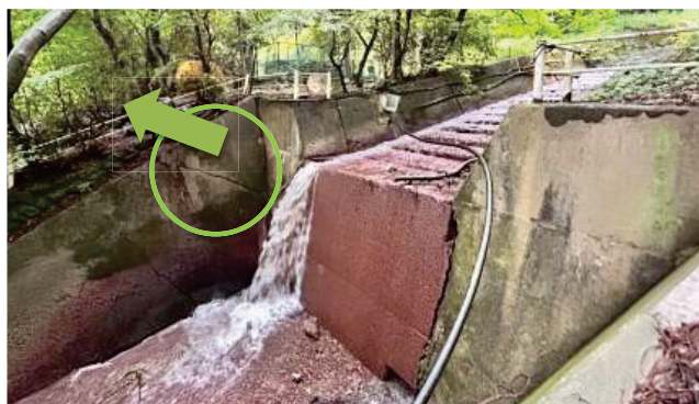
図6 変形集中箇所。ブロック上端における道路の起伏(左、図5の黄緑の地点)と下端部の水路の亀裂(右、図5の紫の地点)。
