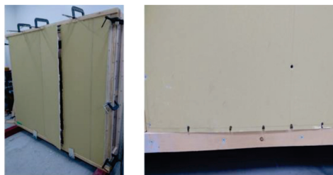
(a) 中央部での割れ
