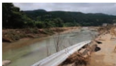
写真4 河岸浸食・崩壊
